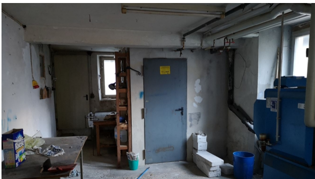
Abb. 13: Technikraum im Grundgeschoss
